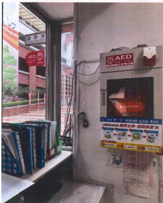
安裝位置：警衛室內
